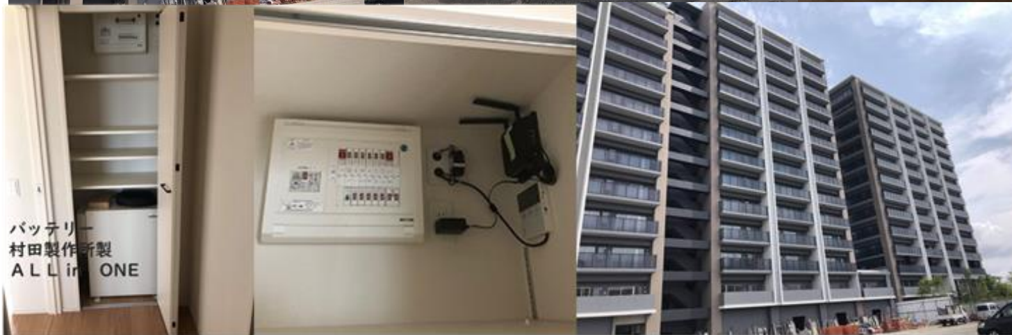
DELIA実証 バッテリー&I通信機器設置の様子 2019年6月 実証中マンション 照葉クロススタイル2019年6月
