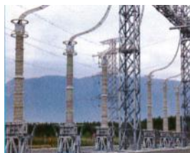
計器用変圧器
