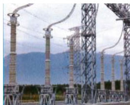
計器用変圧器
