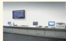
中央監視制御システム
