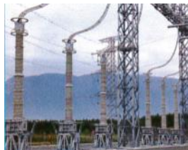
計器用変圧器
