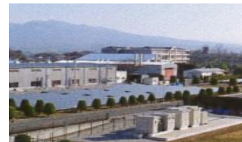
太陽光発電/パワコン
